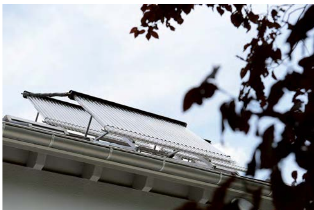
Foto: Bundesverband Wärmepumpe
